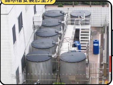
儲水槽安裝於室外
